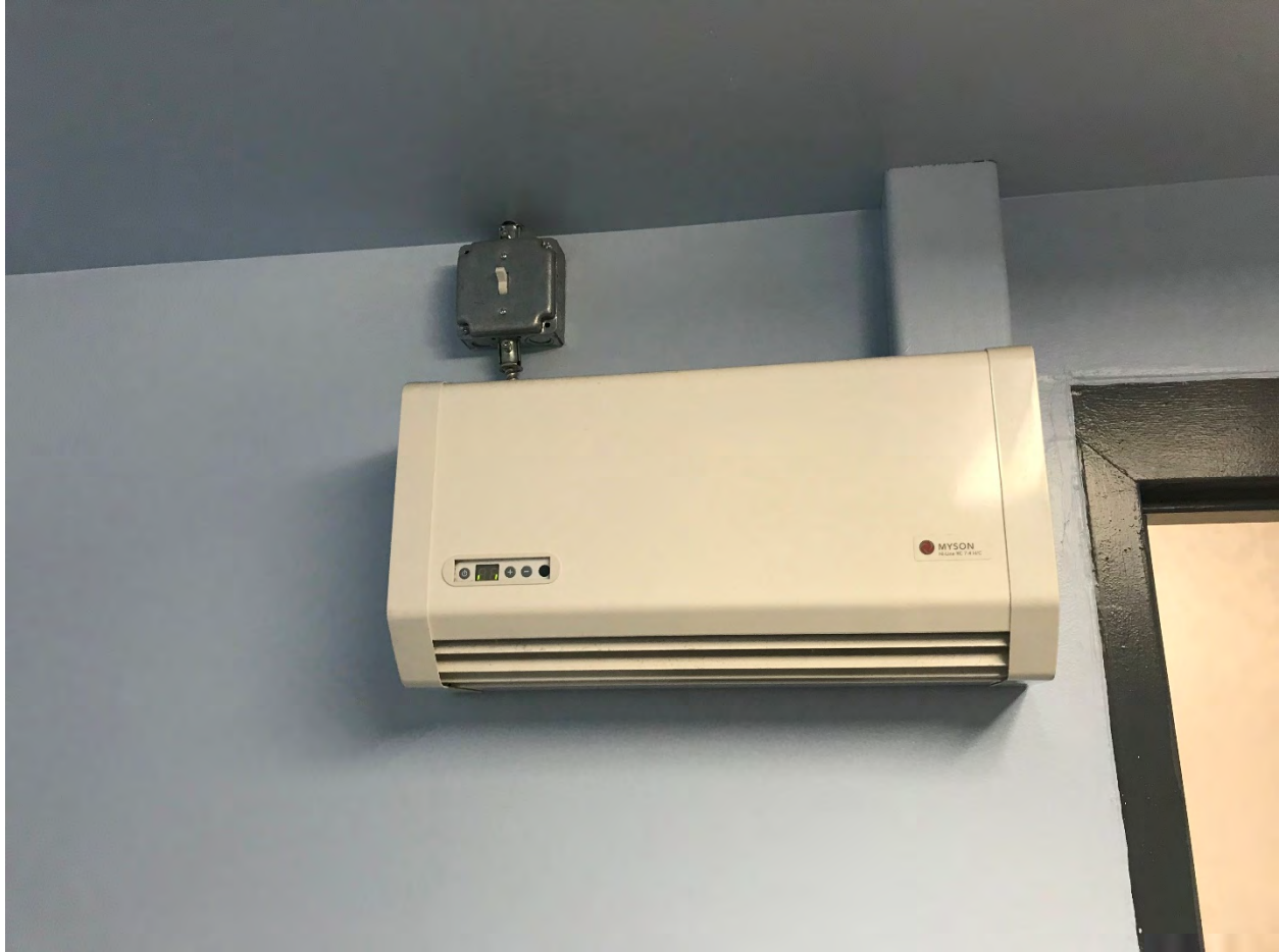
IMAGE 6.14 - POLICE RECORDS RESTROOM MINI SPLIT
